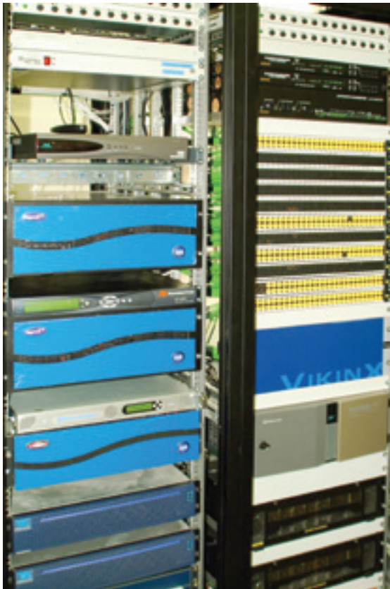
Системное оборудование комплекса
